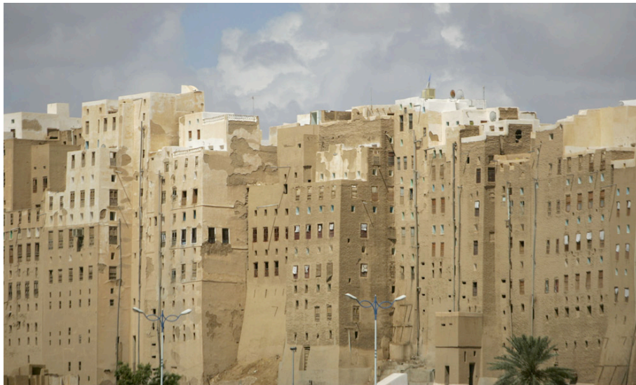
Fig. 13 – Edifici dell'antica città di Shibam il 28 ottobre 2008 dopo la devastante alluvione che ha colpito lo Yemen del sud-est distruggendo centinaia di case di terra-fango e lasciando decine di morti e dispersi. Si possono osservare le facciate degli edifici con le lacune nei rivestimenti e alcune costruzioni senza le coperture.
